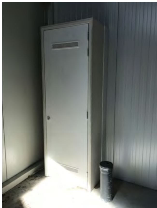
Standaard meterkast + riool (referentiebeeld)
